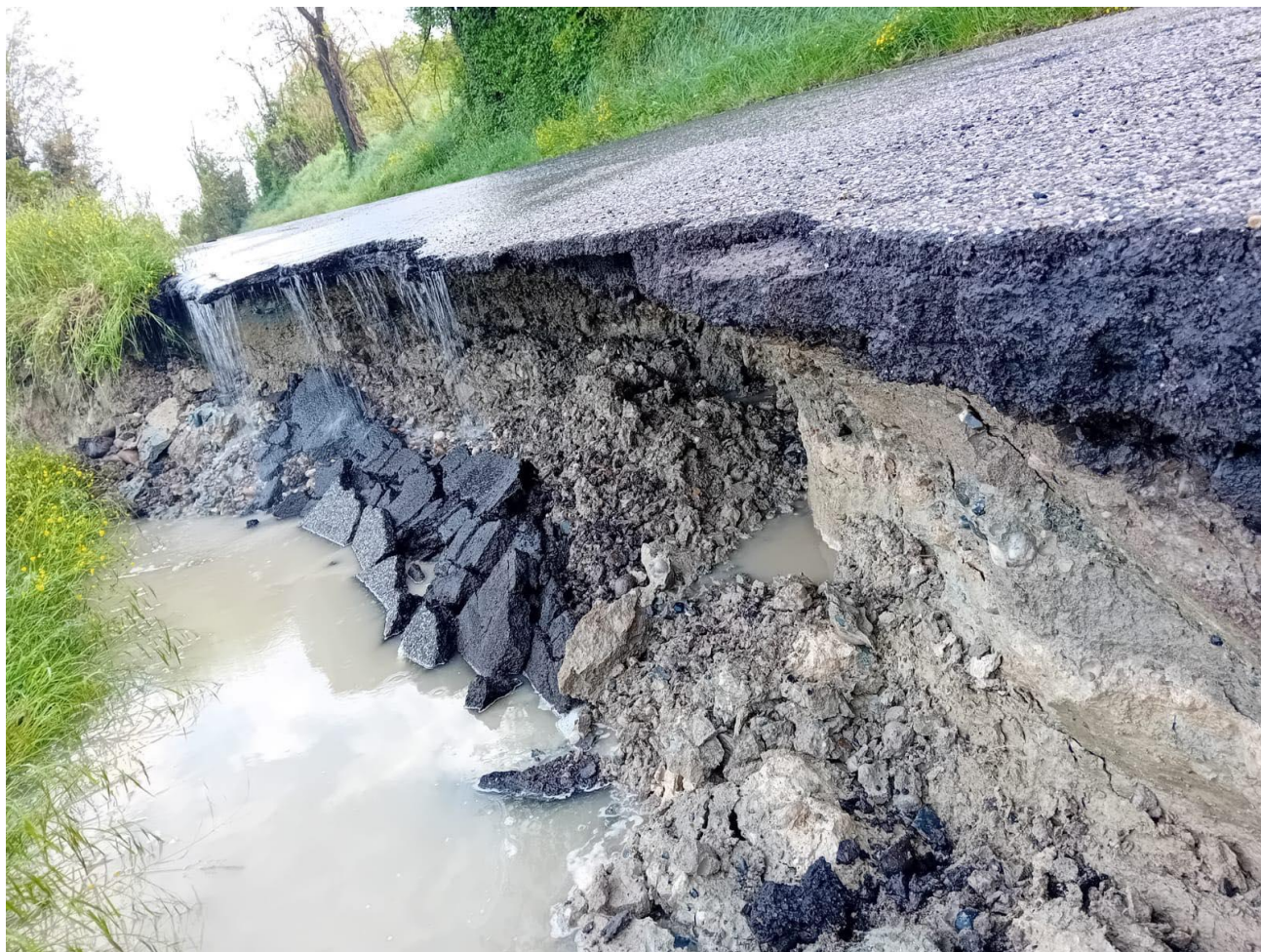
Danneggiamento sede stradale SP34 in Comune di Treville 17 aprile 2025
